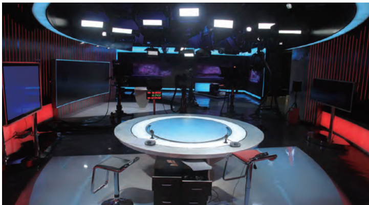
专业照明工程案例实景图
