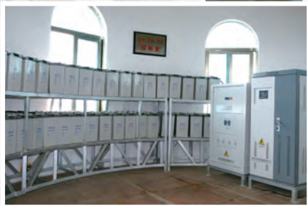
◀ 中建低碳科技楼 – 控制室
